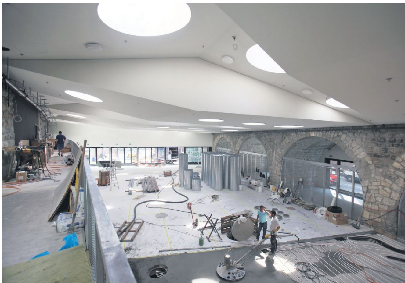
Die Markthalle hat eine auffällige Decke, die mit Oberlichtern gespickt ist. Foto: Sophie Stieger
